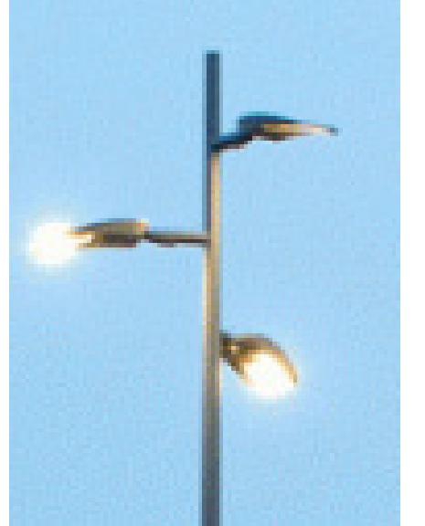
Lichtmast l.p.v. het Hoekje Type: Tocco Leverancier: Schreder Mast: recht en conisch
